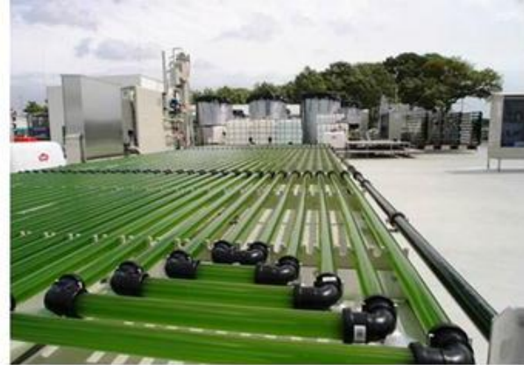
Σωληνοειδείς οριζόντιοι φωτοβιοαντιδραστήρες (PBR)
