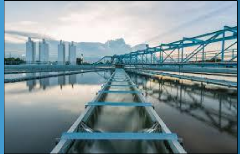
Επεξεργασία Βιομηχανικού νερού
