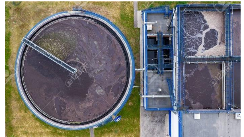
Μονάδα επεξεργασίας νερού: Ιζηματοποίηση, ( www.123rf.com )
