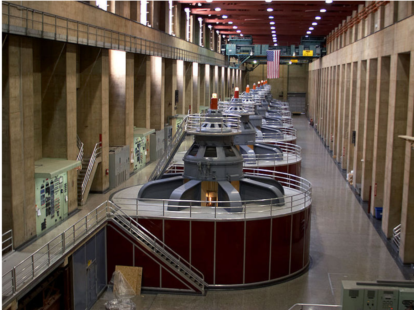
Σειρά Γεννητριών Σύγχρονων Μηχανών σε υδροηλεκτρικό Εργοστάσιο [8]
