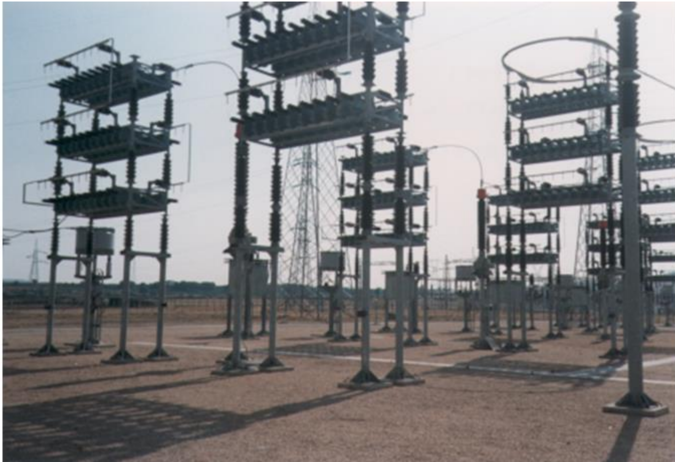
Τράπεζες πυκνωτών υψηλής τάσης.
