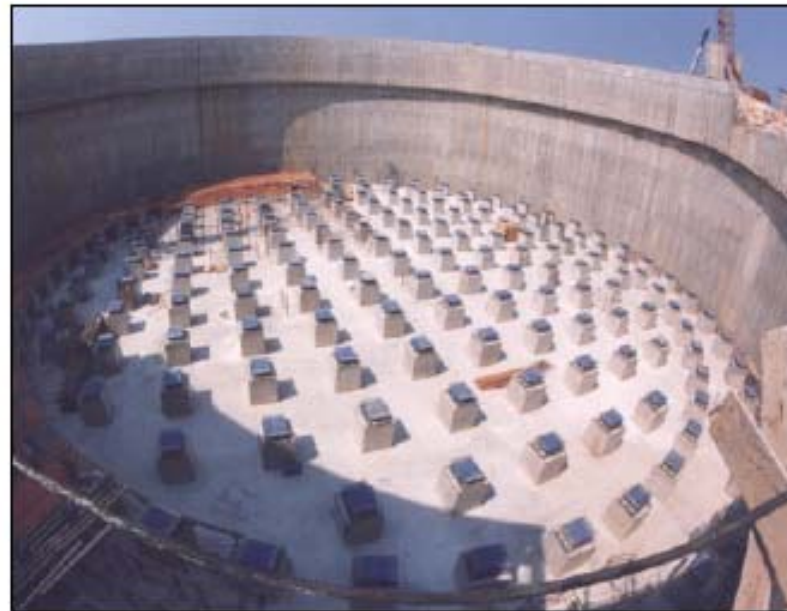
LNG TANKS, REVITHOUSSA, GREECE
