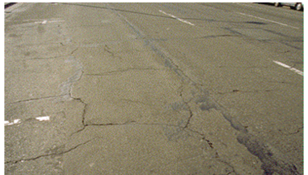
Εικόνα 16 Μεσαίας έντασης ρωγμές συρρίκνωσης
