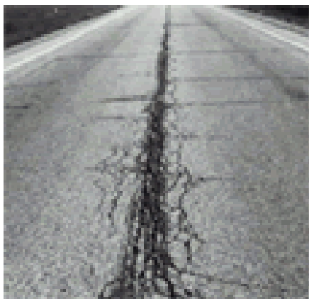
Εικόνα 8 Διαμήκειες ρωγμές σε ένα οδόστρωμα
