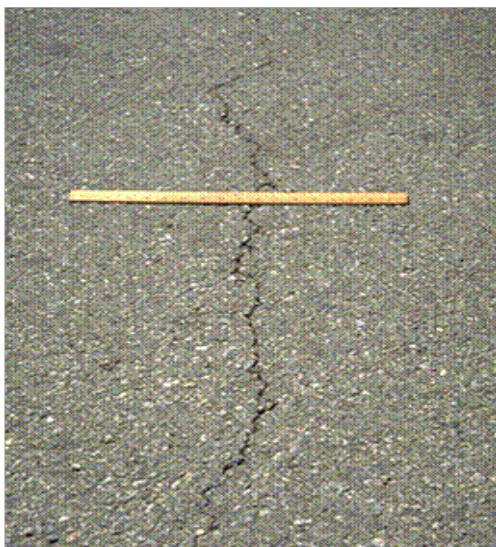
Εικόνα 2 Χαμηλής έντασης ρωγμές τύπου αλιγάτορα
