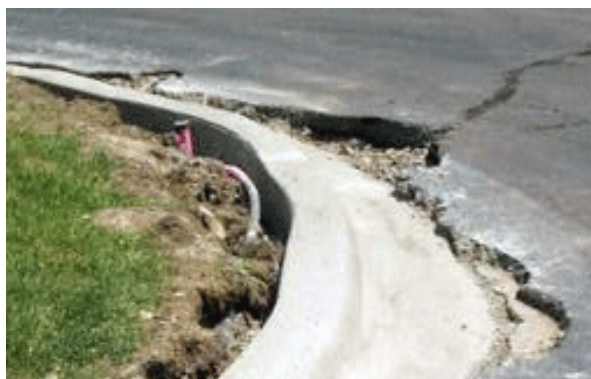
Εικόνα 5 Ρωγμές στα άκρα του οδοστρώματος
