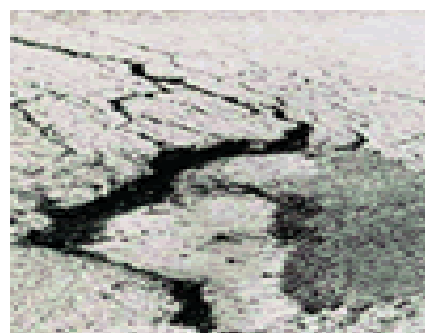
Εικόνα 7 Ρωγμές από ολίσθηση ταπήτων
