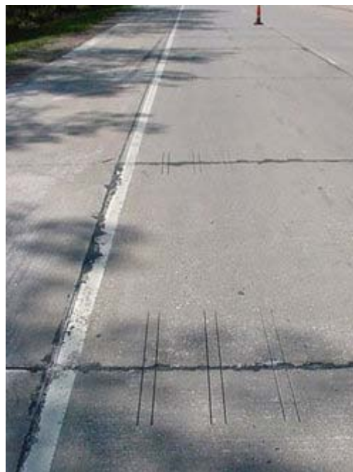
Εικόνα 9 Διαμήκειες και εγκάρσιες ρωγμές
