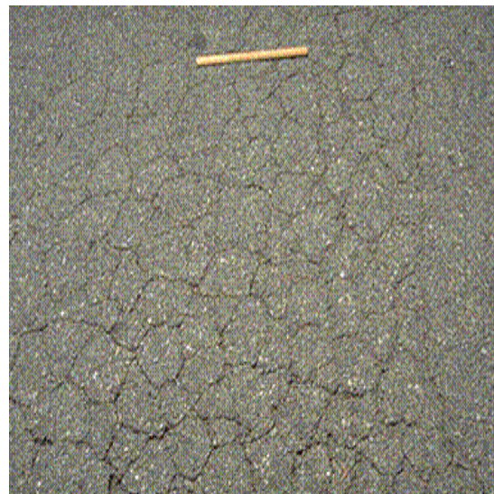
Εικόνα 3 Μεσαίας έντασης ρωγμές τύπου αλιγάτορα
