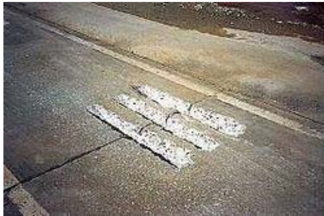
Εικόνα 11 Εγκάρσιες ρωγμές σε οδόστρωμα
