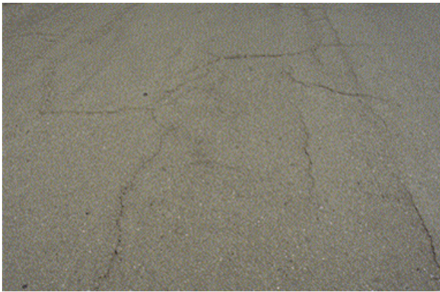
Εικόνα 15 Χαμηλής έντασης ρωγμές συρρίκνωσης
