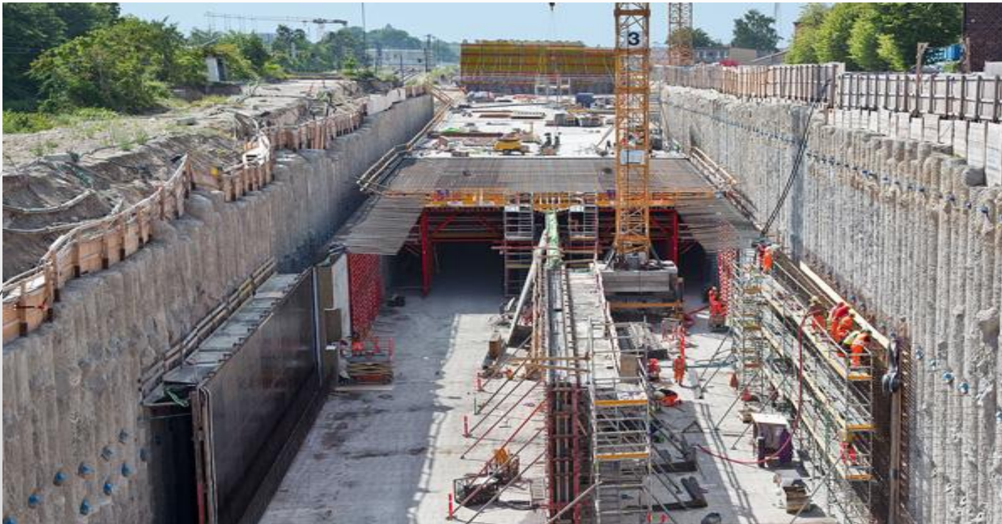
Μέθοδος cut and cover με αυστηρό πλάτος μετώπου εργασιών (κατακόρυφες παρειές εκσκαφής)
