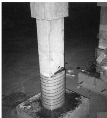
Σχ. 2.10 Κατασκευή ελλειπτικού μανδύα στην κρίσιμη περιοχή υποστυλώματος και προένταση με χρήση διογκούμενου κονιάματος στο κενό μεταξύ υποστυλώματος και μανδύα.
