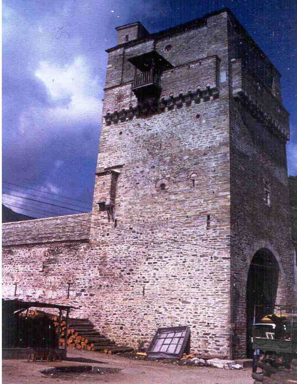
Μονή Ιβήρων, Πύργος Αρσανά : συντηρητική επέμβαση με σεβασμό στην αυθεντικότητα (10η ΕΒΑ (Πλ. Θεοχαρίδης)
