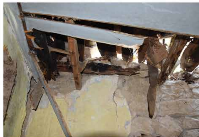
Εικ.Ορ. 22 Λεπτομέρεια ζημιάς στο ταβάνι του 2.05
