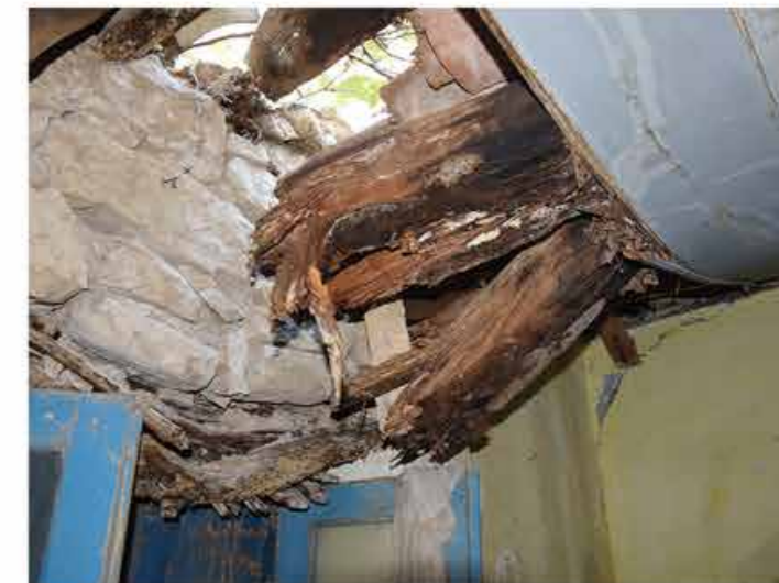
Εικ.Ορ. 23 Λεπτομέρεια ζημιάς στο ταβάνι του 2.05
