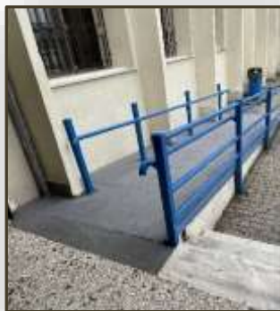
Εικόνα 8. Ράμπα παράλληλα στο κτίριο (1 ο Γυμνάσιο Γρεβενών)
