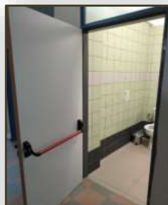
Εικόνα 183. Πόρτα με μπάρα (3° Δημοτικό σχολείο Αμυνταίου Φλώρινας)
