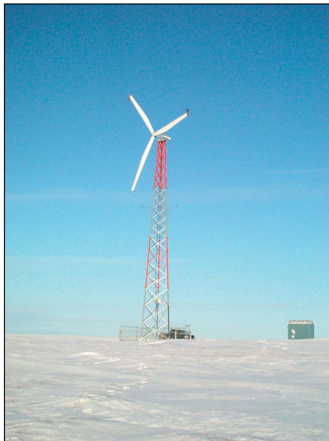
Εικόνα 5: Ανεμοκινητήρας 50 kW απομονωμένου δικτύου στην Αρκτική.
