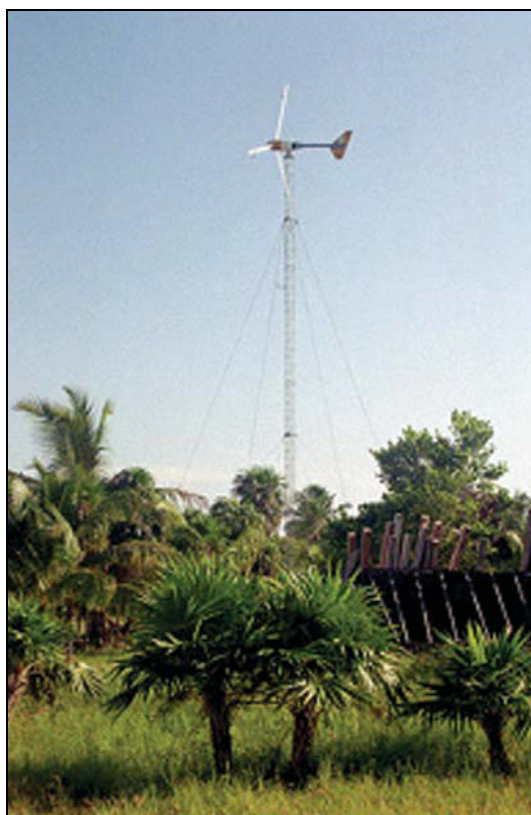
Εικόνα 4: Ανεμοκινητήρας 10 kW εκτός – δικτύου στο Μεζικό.
