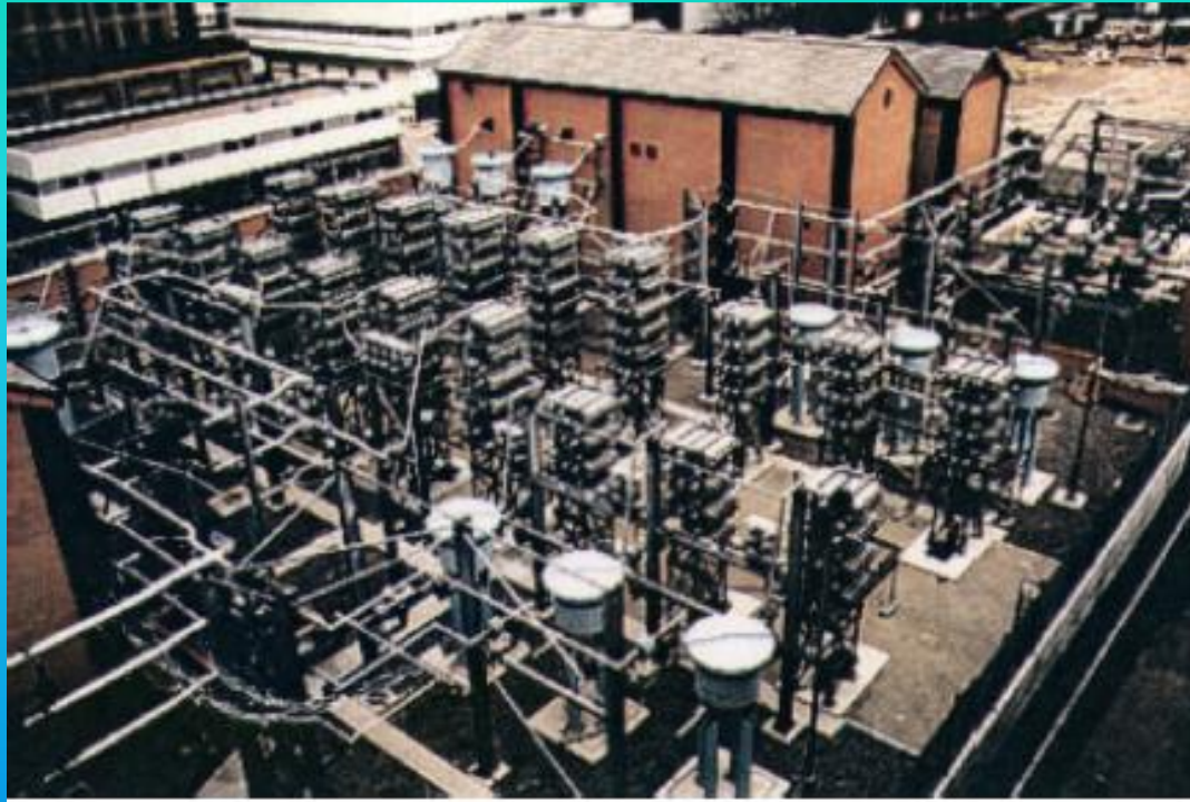
Σταθμός SVC στο Λονδίνο.
