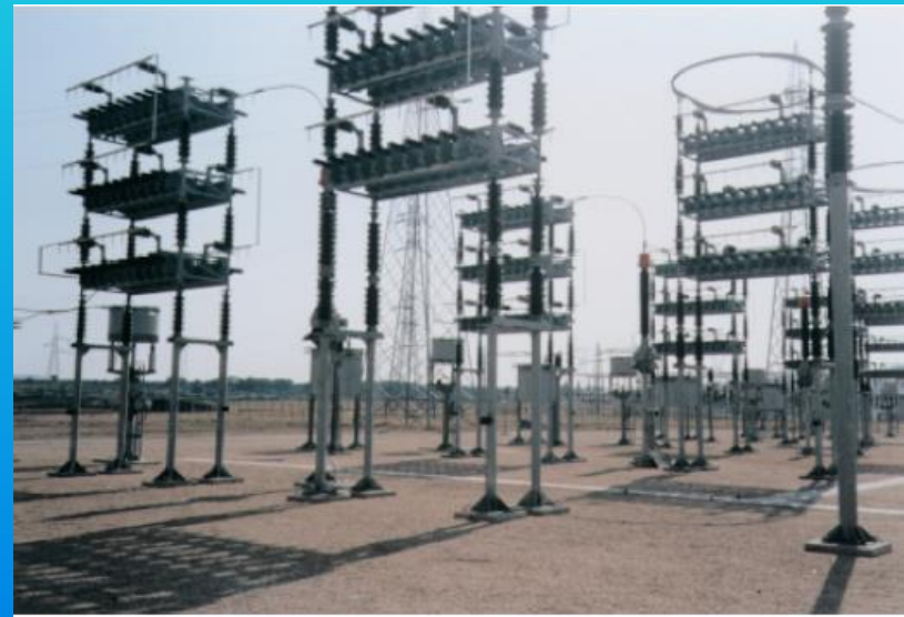
Τράπεζες πυκνωτών υψηλής τάσης.
