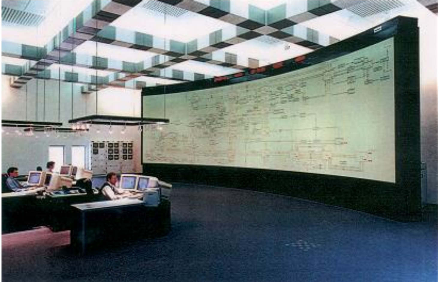
Εσωτερικό του ΚΕΕ της ΔΕΗ
