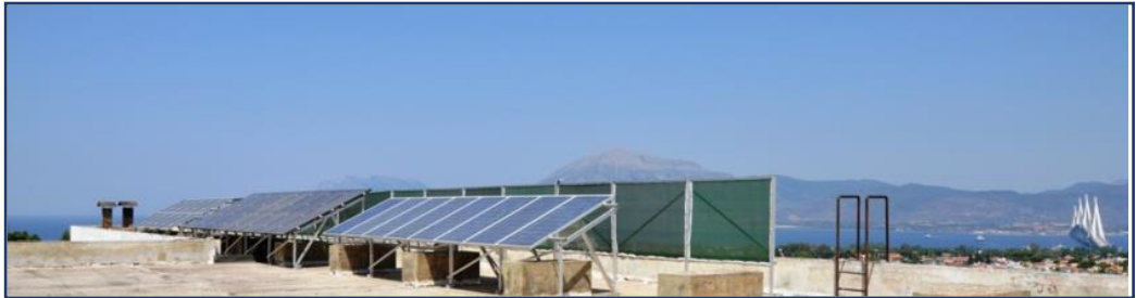
Σχήμα 1: Το πρότυπο φωτοβολταϊκό μας πάρκο στη ταράτσα του κτιρίου Χημικών Μηχανικών
