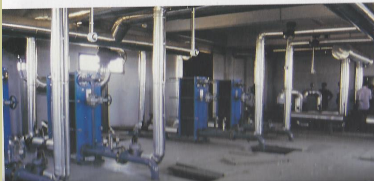
Σχήμα 6.14. Φωτογραφία του κεντρικού μηχανοστασίου του πεδίου Ν. Κεσσάνης Ξάνθης. Διακρίνονται οι εναλλάκτες θερμότητας, οι μονωμένες σωληνώσεις
