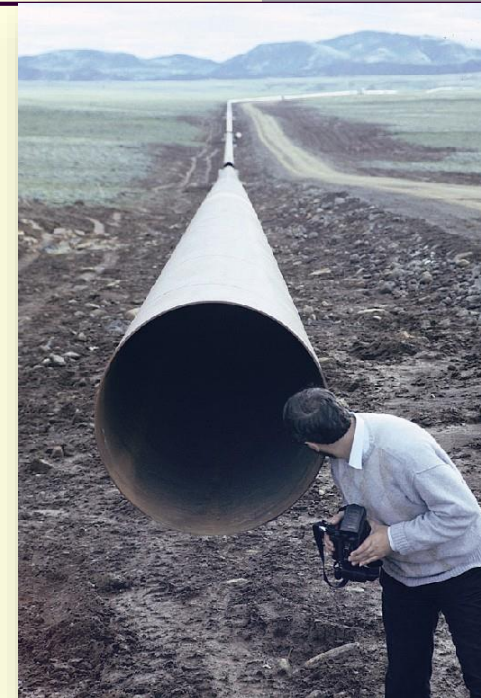
Τοποθέτηση υπέργειας σωλήνωσης μεταφοράς θερμού νερού από το Nesjavellir στο Reykjavik της Ισλανδία
