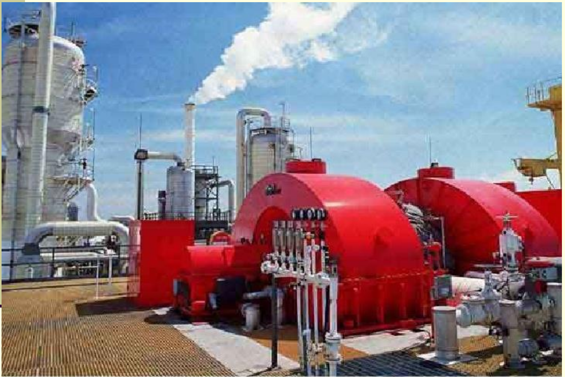
Στροβιλογεννήτριες παραγωγής ηλεκτρικού ρεύματος από γεωθερμία, Καλιφόρνια ΗΠΑ
