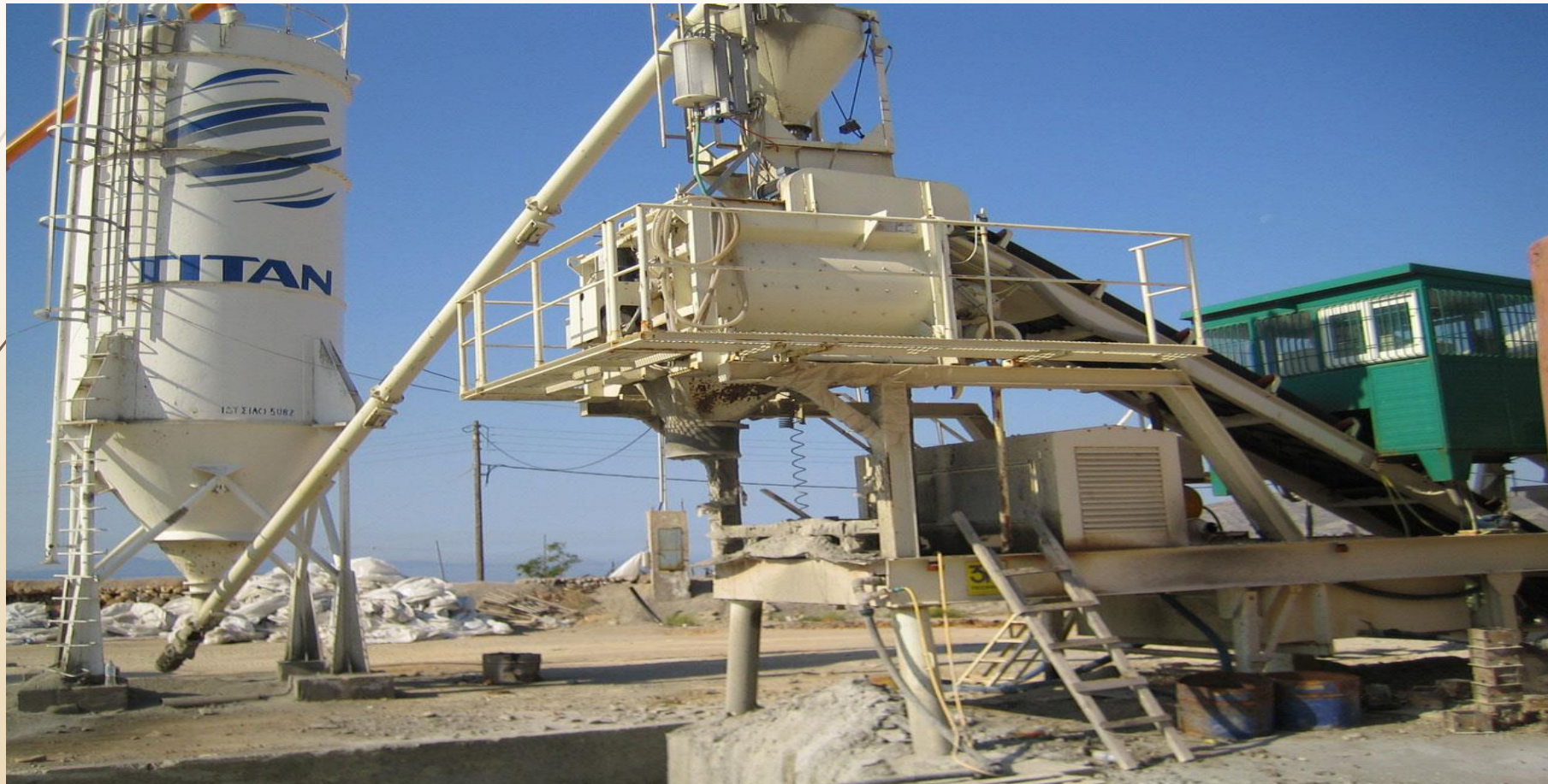
Συγκρότημα παραγωγής σκυροδέματος
