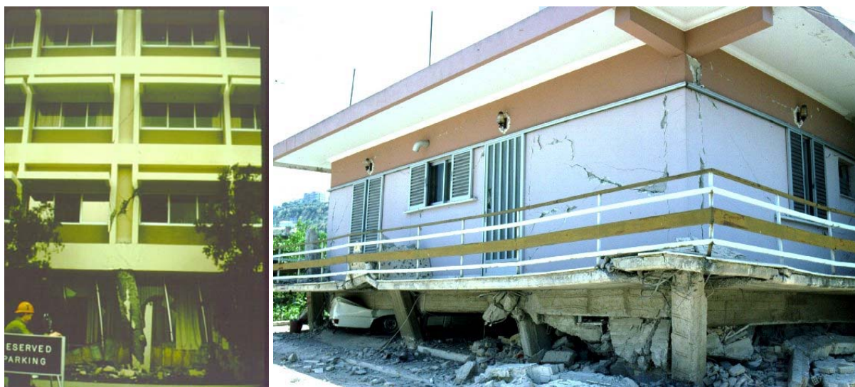
Σχήμα 3.10 Αστοχίες σε κτίρια με λιγότερες τοιχοπληρώσεις στο ισόγειο. Αριστερά: Olive View Hospital, σεισμός San Fernando, Καλιφόρνια, 1971. Δεξιά: Αίγιο, 1995.
