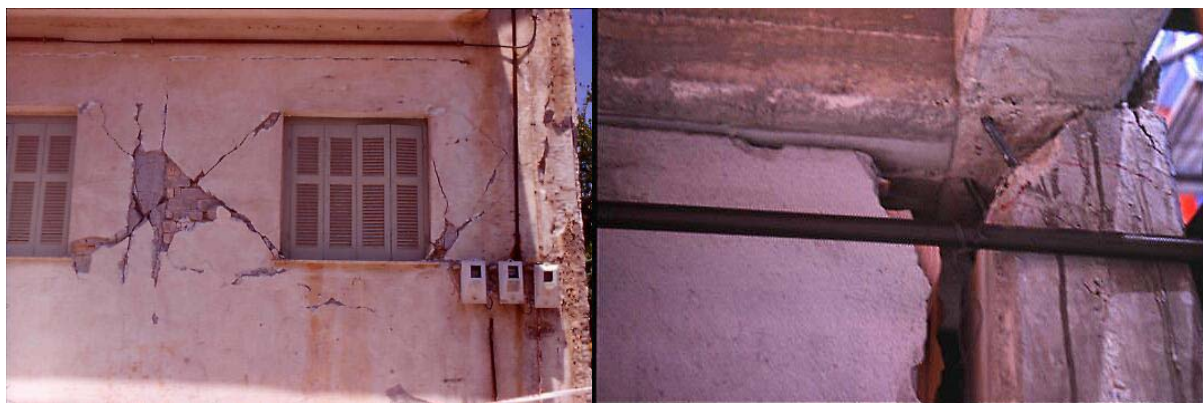
Σχήμα 3.12 Διατμητικές αστοχίες ασθενών υποστυλωμάτων λόγω ισχυρών τοιχοπληρώσεων
