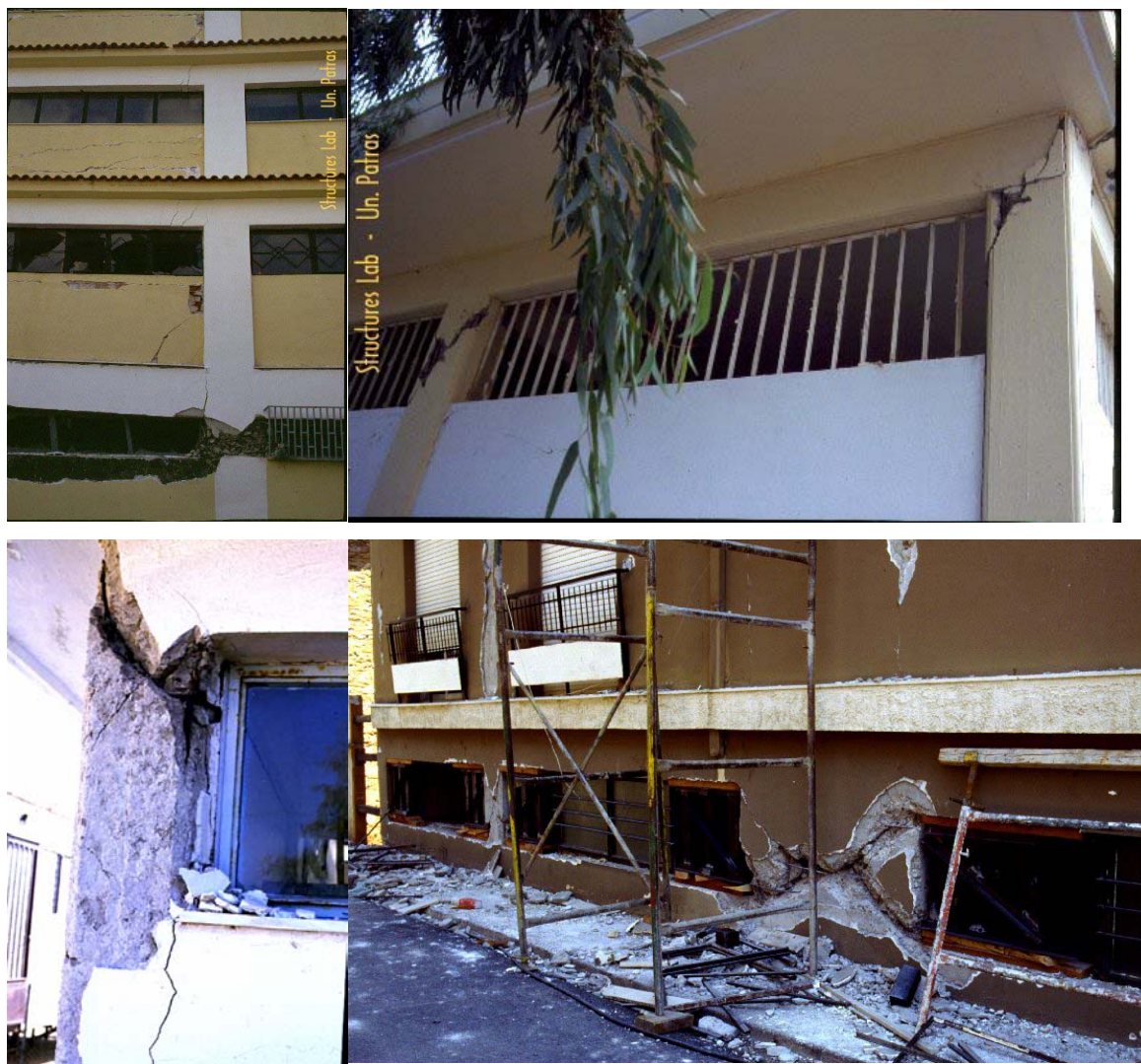
Σχήμα 3.11 Διατμητικές αστοχίες κοντών υποστυλωμάτων (Πάνω: Σεισμός Πάρνηθας, 1999. Κάτω: Αριστερά:Κυλήνη, 1988, Δεξιά: Αίγιο, 1995).
