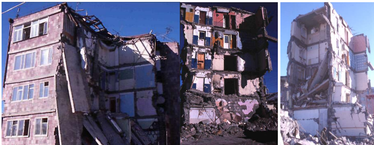
Σχήμα 3.8 Καταρρεύσεις κτιρίων με προκατασκευασμένα πατώματα, λόγω ελλιπούς σύνδεσης με τα κατακόρυφα στοιχεία (Spitak, Αρμενία, 1988).
