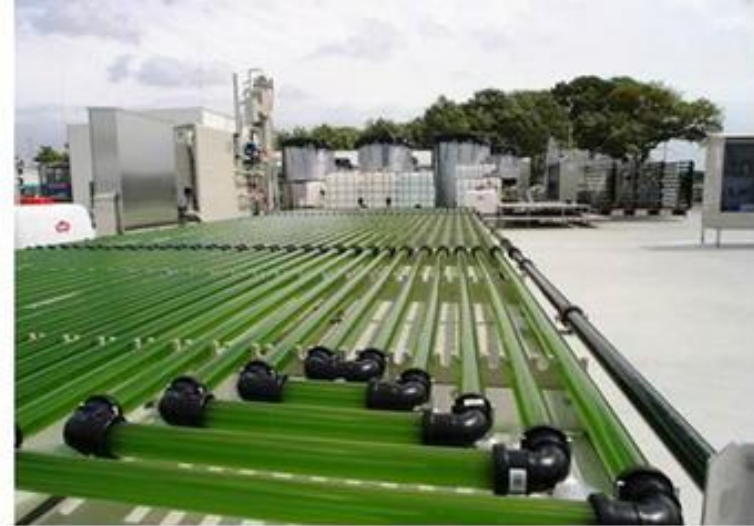
Σωληνοειδείς οριζόντιοι φωτοβιοαντιδραστήρες (PBR)
